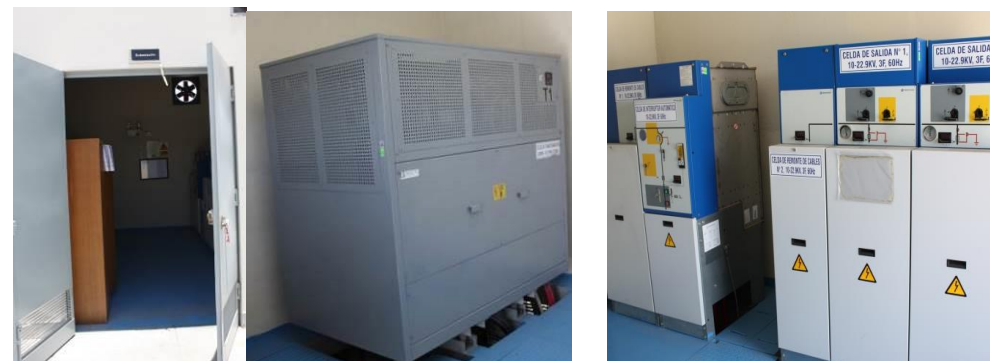
Ilustración 51 - Cuarto Subestación Eléctrica
