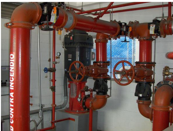
Ilustración 45 - Sistema contra Incendios
