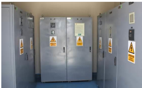
Ilustración 49 - Cuarto de Tableros Eléctricos
